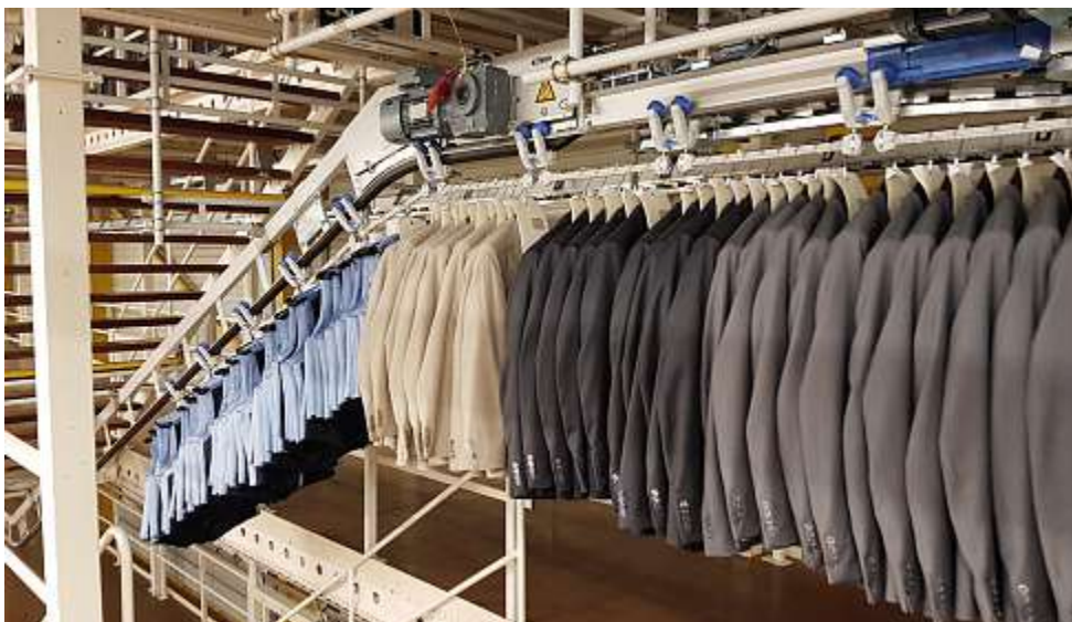
Die neuen Etagenförderer wurden innerhalb einer Woche installiert. Der Transport zwischen den verschiedenen Etagen erfolgt vollautomatisch.
